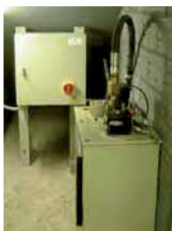
Equipo Hidráulico / Hydraulic Equipment
