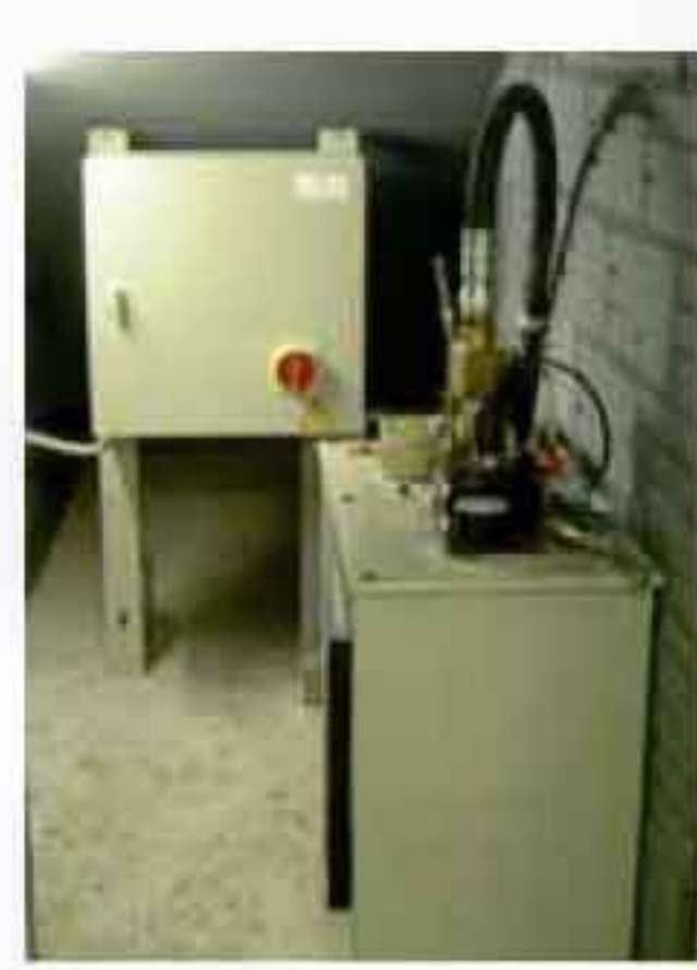
Equipo hidráulico Hydraulic equipment
