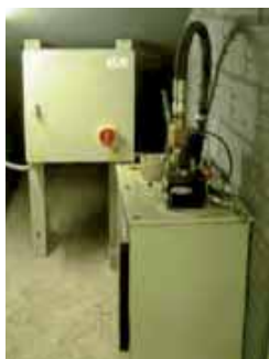
Equipo Hidráulico / Hydraulic Equipment
